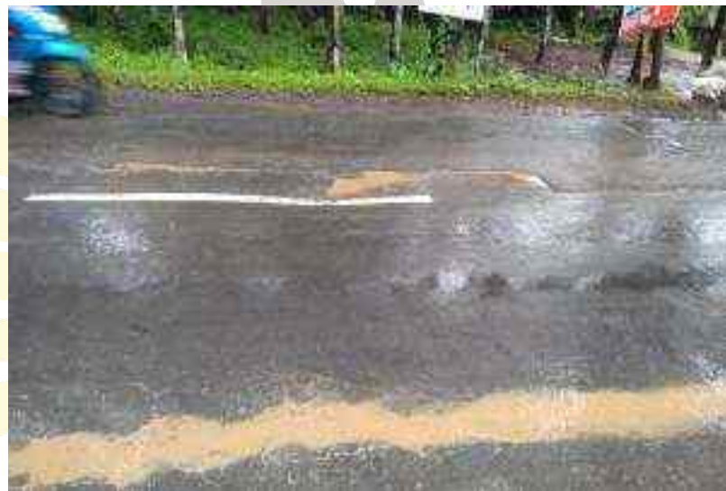
Gambar 1. 2 Kerusakan retakan rusak tambalan yang tergenang air (Sumber : Dokumentasi Lapangan, Juni 2020)
