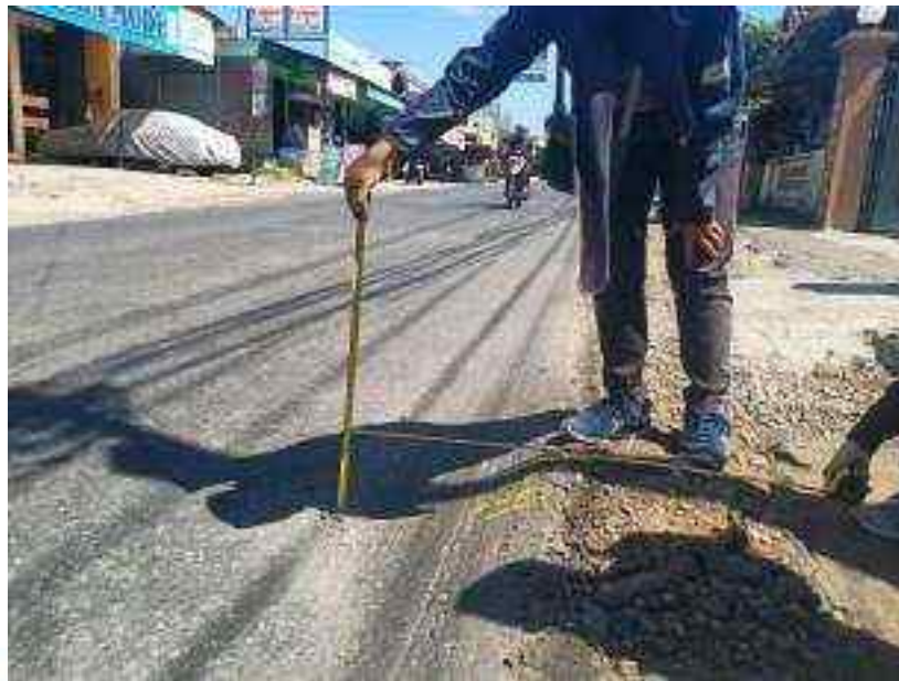
Foto Pengukuran Kerusakan Jalan
