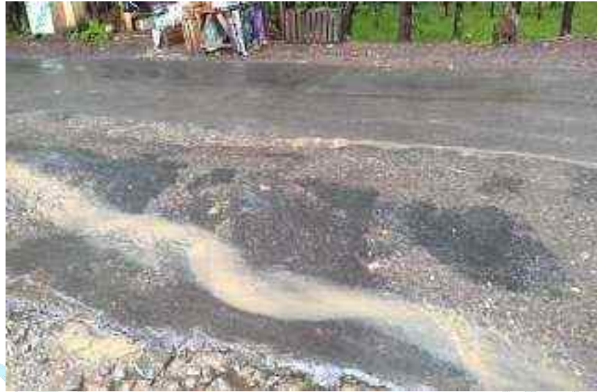
Gambar 1. 1 Kerusakan Ambblas pada Ruas Jalan Salatiga-Kedungjati (Sumber : Dokumentasi Lapangan, Juni 2020)
