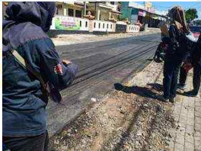
Foto Pengukuran Kerusakan Jalan
